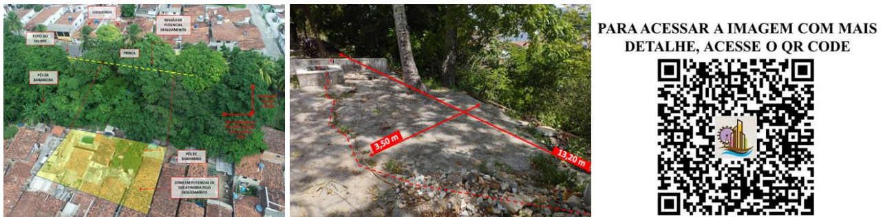
Figura 4. Trinca no talude do bairro São José.
