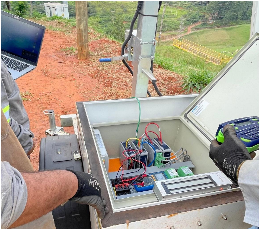
Figura 1. Atividade de campo realizada para comissionamento de rede da instrumentação sísmica presente em uma barragem de mineração. Na imagem é possível notar os componentes eletrônicos do sistema microssísmico que ficam armazenados numa carretinha. (Imagem do autor, 2024).
