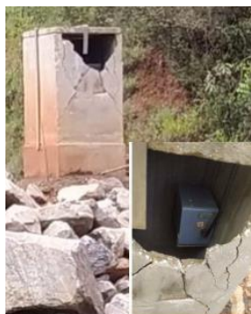
Figura 8. Exemplo de Tiltimeter danificado por maquinário em campo (Autor, 2022)
