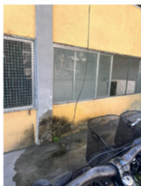
Figura 1: Água do ar-condicionado caindo sob o bicicletário principal.
