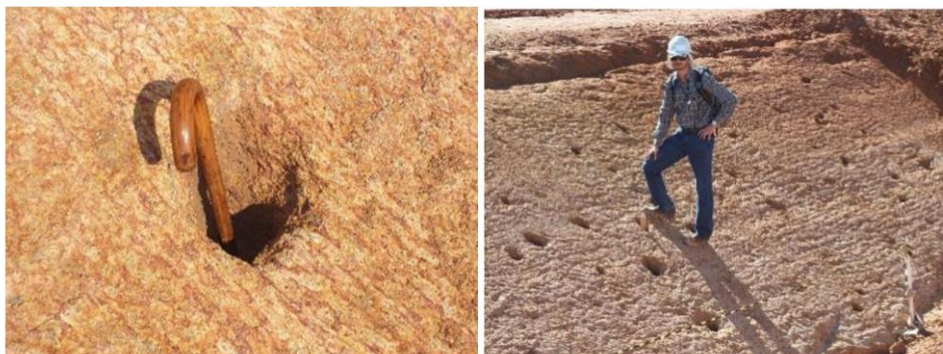
Figura 1. Canaliculos encontrados na trincheira exploratória do Dique 19B, em Belo Monte.
