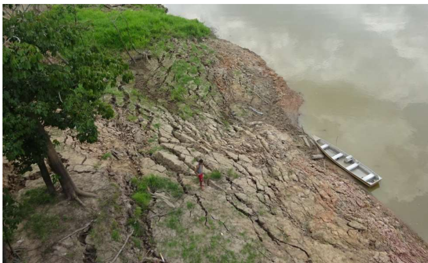
Figura 2. Diversas trincas e degraus de abatimento nas margens de rio, evidenciando o fenômeno de “Terras Caídas”. Fonte: Autores, 2022.
