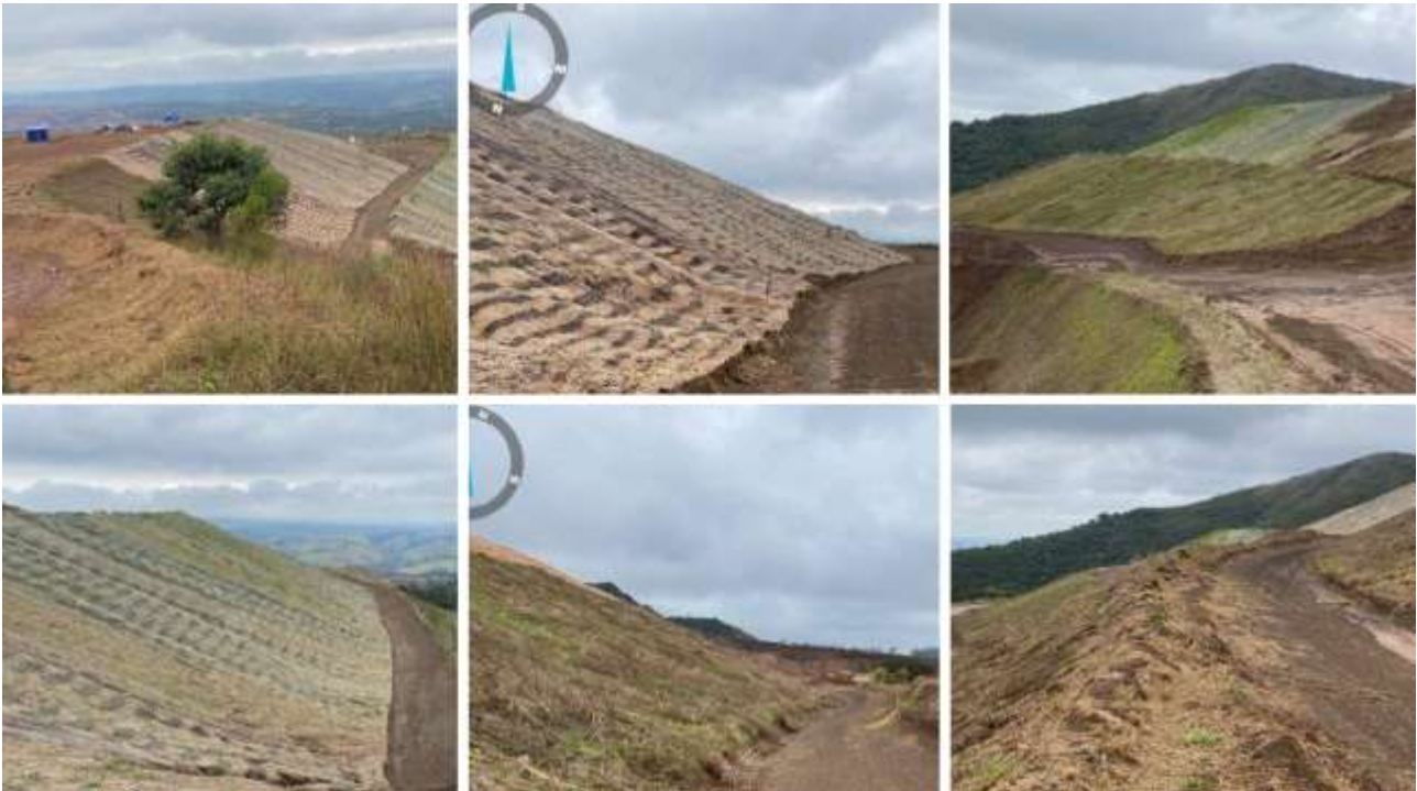
Figura 3. Imagens da inspeção visual realizada na estrutura. Fonte: Os autores.
