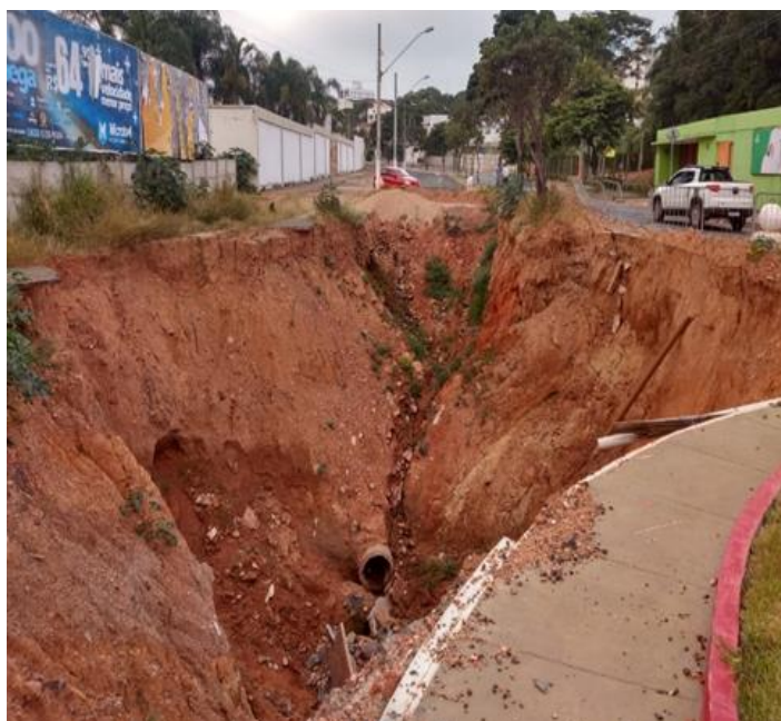
Figura 1. Fotografia do local da ruptura na Avenida Lúcio Diniz Guimarães.
