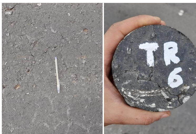
a) Observação das trincas no pavimento. b) Extração de testemunhos para observação.
