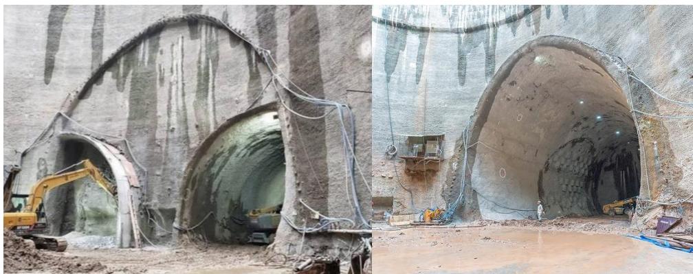
Figura 4. Túnel de Ligação da Futura Estação Santa Isabel (em execução) com seção elíptica: (a) detalhe dos side-drifts (Fonte: Via Trolebus); (b) seção escavada para abertura dos emboques dos túneis de plataforma (Fonte: Márcia Alves/Metrô SP).
