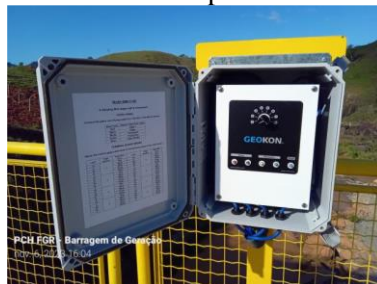
Figura 14. Cabine de leitura da instrumentação instalada
