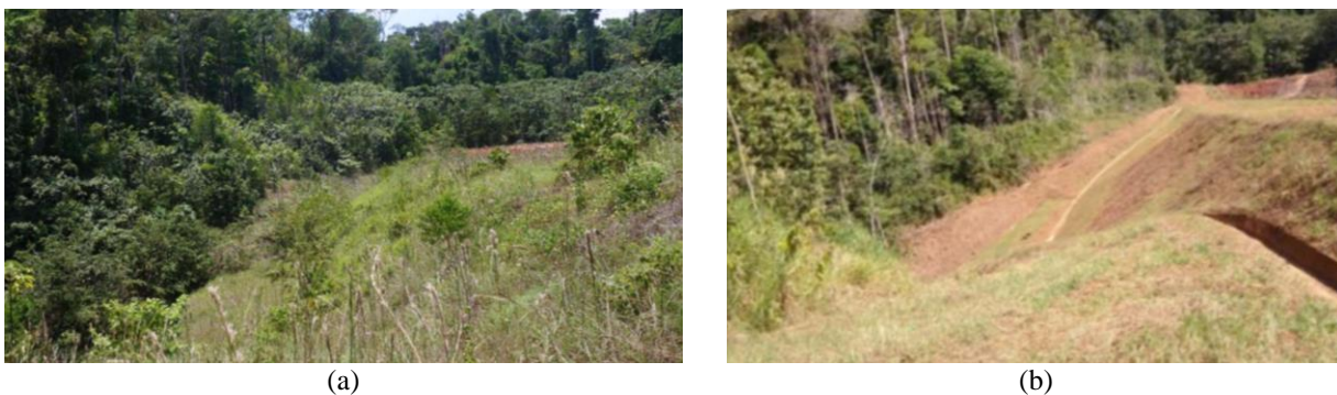
Figura 1. Em (a), aspecto do barramento após vários anos sem manutenção e monitoramento. Em (b), barramento após primeira etapa de manutenção.
