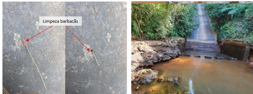
Figura 6. Observados drenos barbacãs obstruídos e bacia dissipadora com os dentes de concreto com sinais de desgaste.
