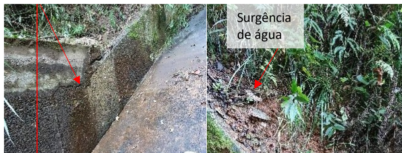
Figura 2. Observado surgência d'água representando saturação do maciço nas paredes laterais da rampa do vertedouro.
