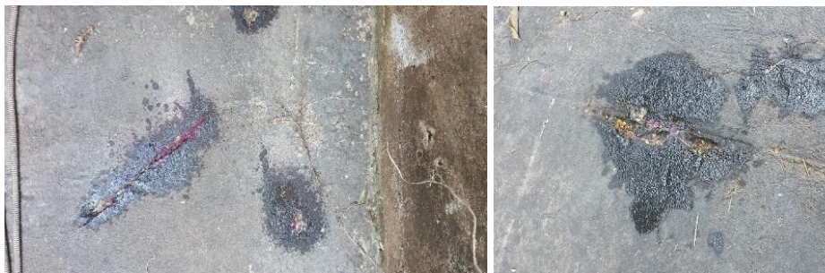
Figura 5. Execução do teste de carbonatação na estrutura do vertedouro, com a utilização da solução de fenolftaleína.
