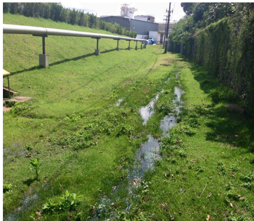
Figura 1. Surgência de percolado por capilaridade no pé do talude da margem da lagoa.
