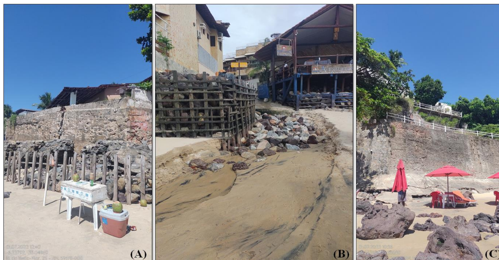
Figura 3. Estruturas de contenção existentes na Praia do Centro; (A) Muro de arrimo fissurado; (B) Enrocamento com presença de intensificação do processo erosivo; (C) Estrutura fissurada devido ao esforço gravitacional após o deslocamento dos sedimentos de sua base.
