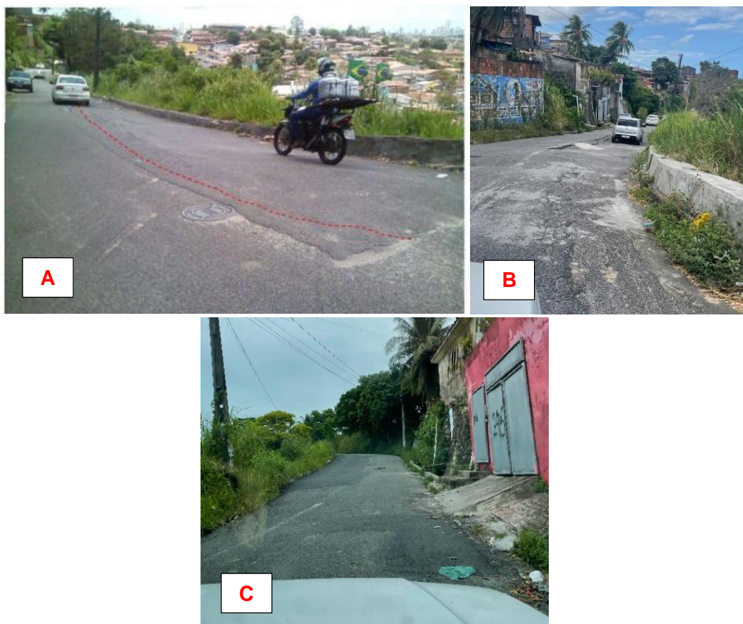
Figura 6. Histórico da trinca no talude de estudo.
