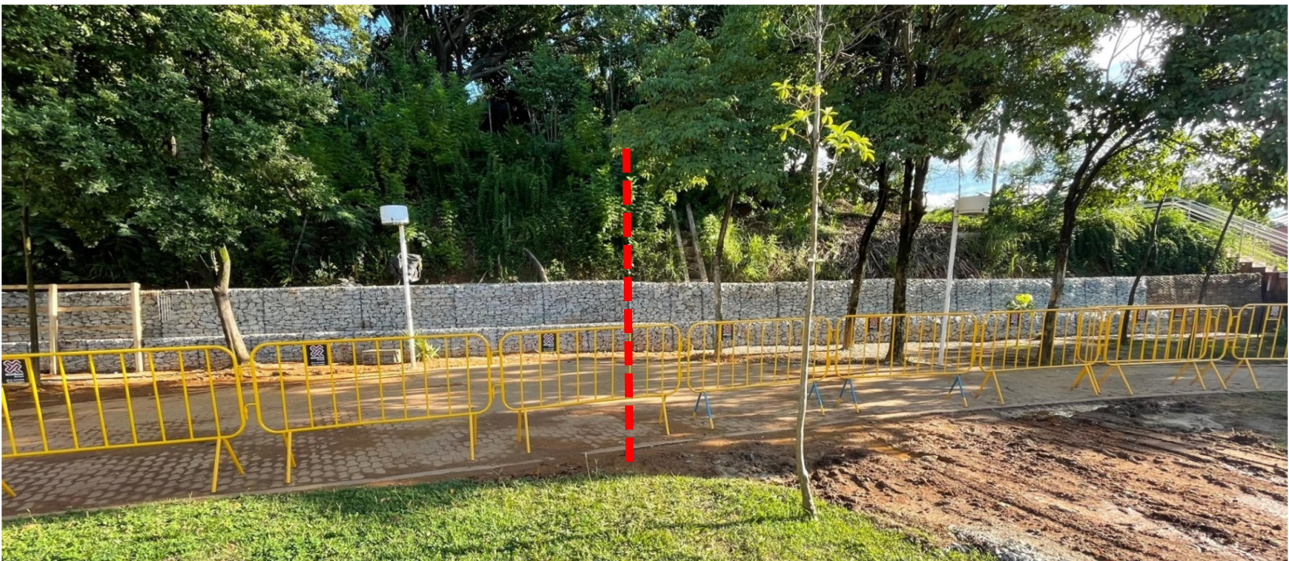
Figura 8. Muro de gabião experimental, trecho a esquerda em gabião de malha soldada e trecho a direita em gabião de malha tecida.
