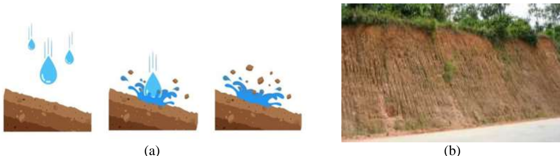
Figura 1. (a) Representação de erosão hídrica (b) Erosão superficial em talude.
