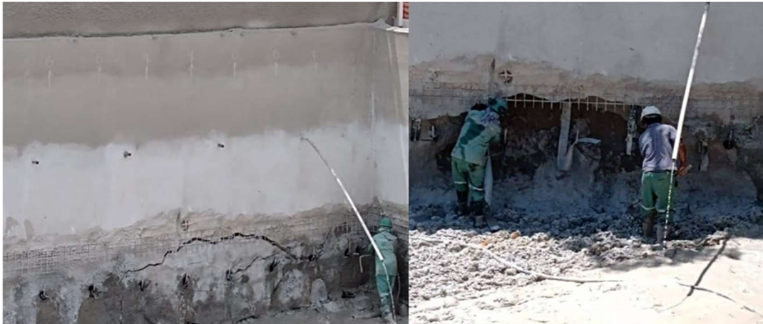
Figura 6. Trinca onde ocorrerá deslocamento e talude após a ocorrência
