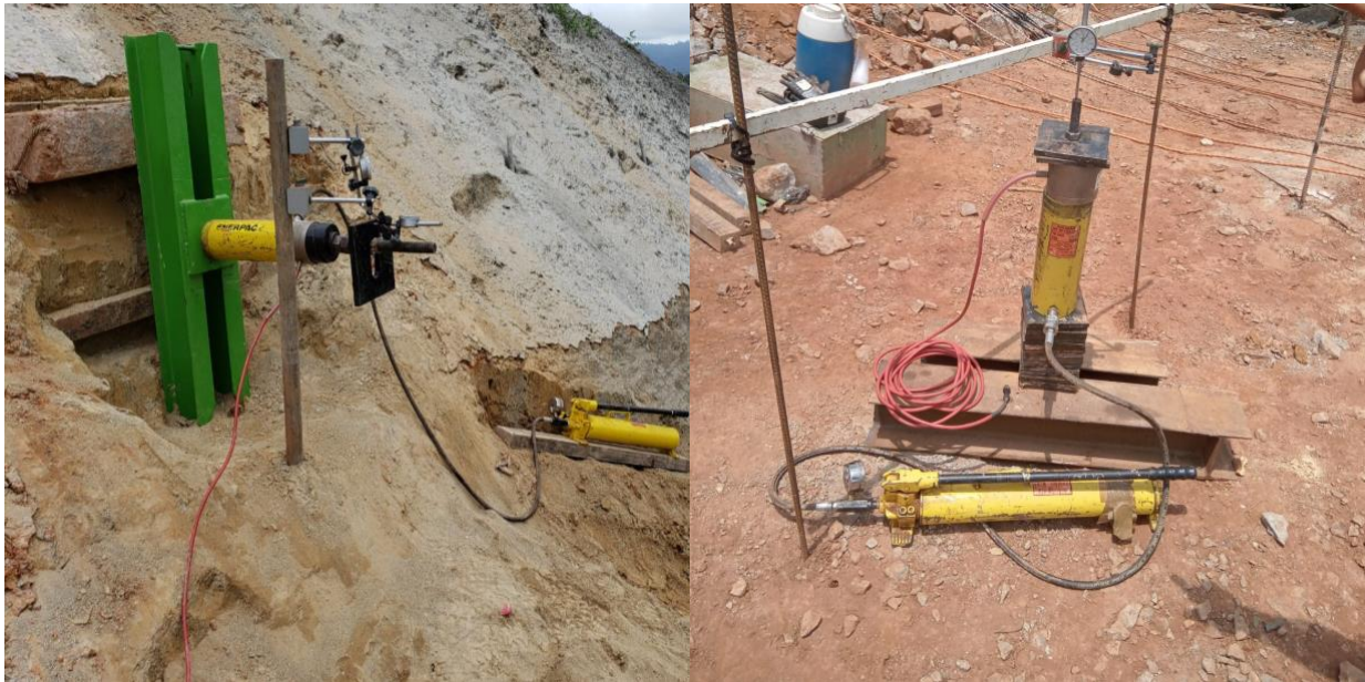
Figura 5. Montagem de ensaio de arrancamento sub-horizantal no talude 1 à esquerda e vertical à direita
