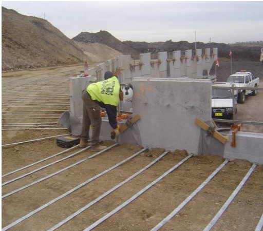
Figura 5 – Muro com Fitas em Aço
