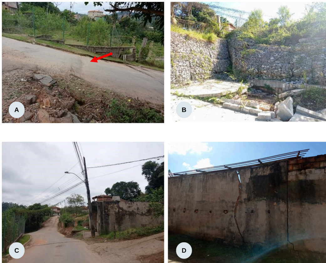
Figura 1 – Indícios do rastejo: A) abatimento da via; B) deformação do muro de contenção; C) poste inclinado; D) trincas nas paredes.
