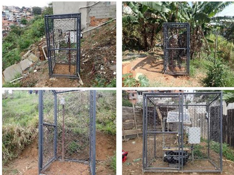
Figura 7. Sensores instalados no monitoramento piloto.
