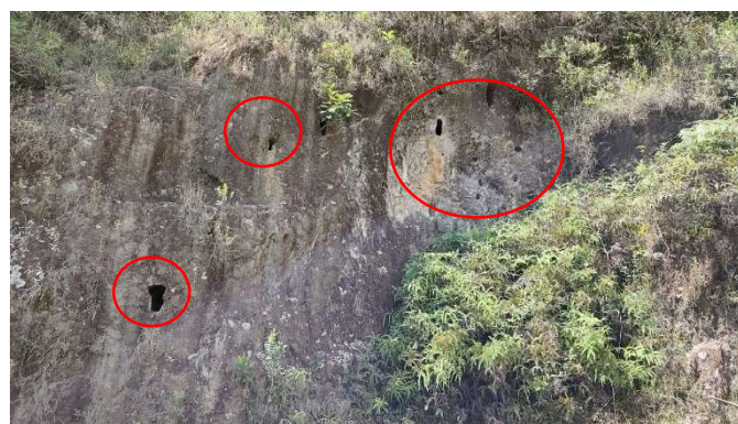
Figura 7 – Orifícios identificados no maciço.
