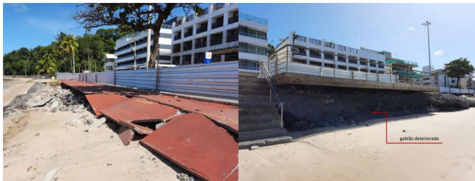
Figura 1. Condição das estruturas existentes, fonte: SEINFRA
