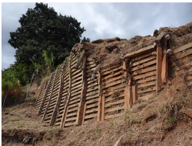
Figura 6. Muro tipo Crib-Wall após a ruptura do talude (O autor, Julho/2018).
