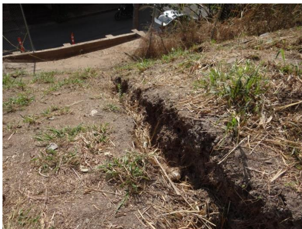
Figura 7. Trinca longitudinal no terreno. (O autor, Julho/2018).
