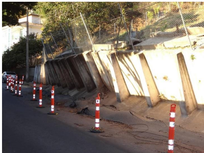
Figura 4. Muro de concreto armado semi-tombado na base do talude (O autor, Julho/2018).
