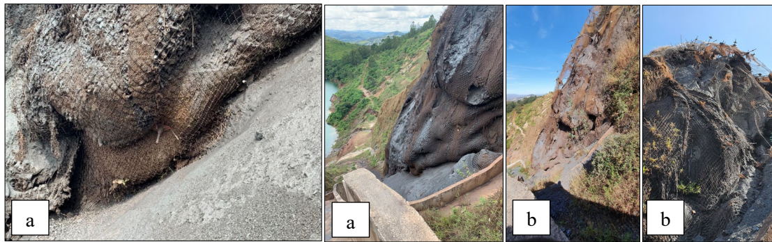
Figura 2-3: Sobrecarga Porção Inferior (a) e Grampos Expostos (b).
