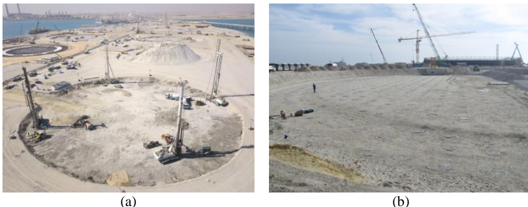
Figura 4. Execução projeto tanques de gás natural (a) Processo de escavação hélice contínua (b) inclusões rígidas finalizadas (Bernuy et al., 2018)
