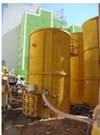
Figura 2 - Vista do floculador
