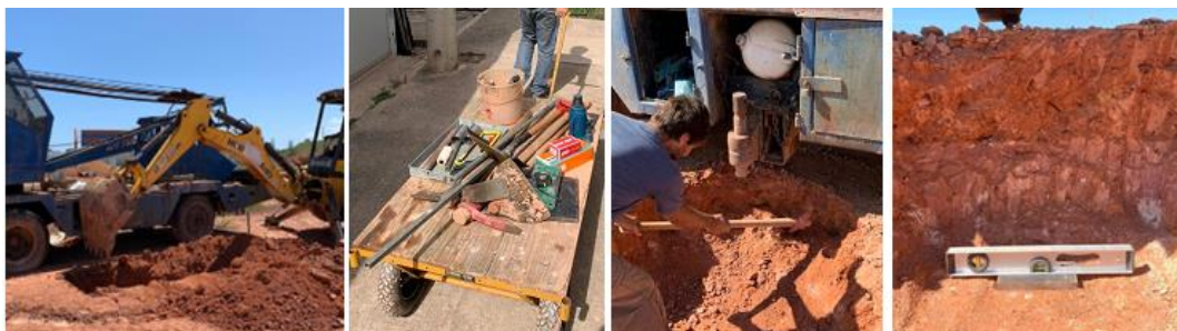
Figura 4. Sequência de execução das cavas para assentamento da placa nas provas de carga.
