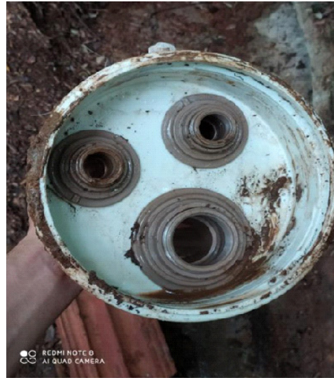
2B - Retirada da tampa frontal para limpeza
