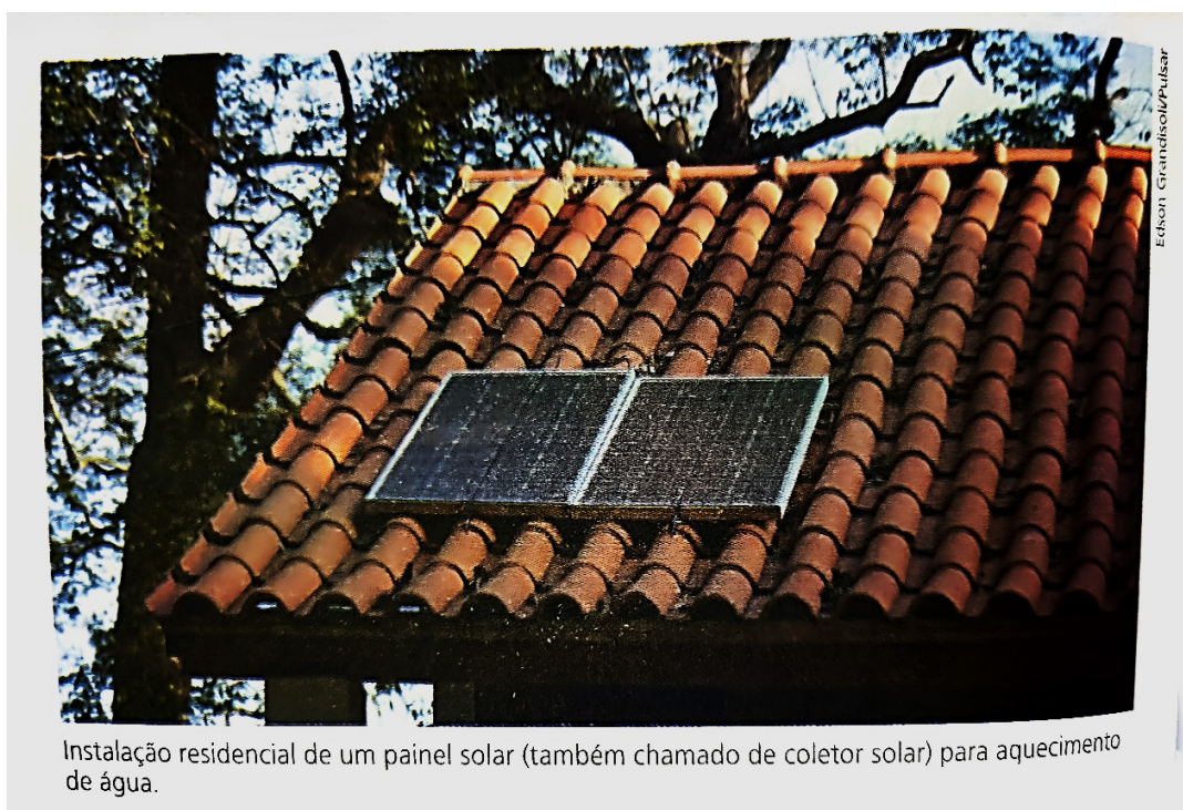
Figura 1: Aplicação do conceito de energia por meio do uso de painéis solares para aquecimento de água.
