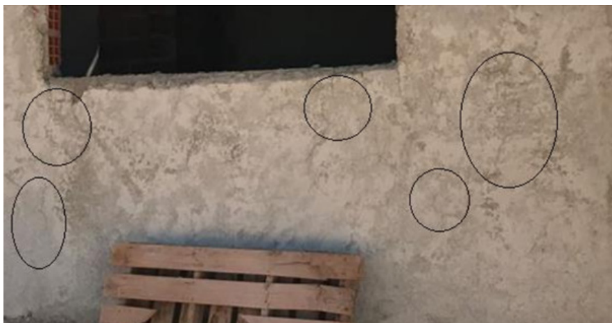
Figura 10. Detalhe das fissuras verificadas
